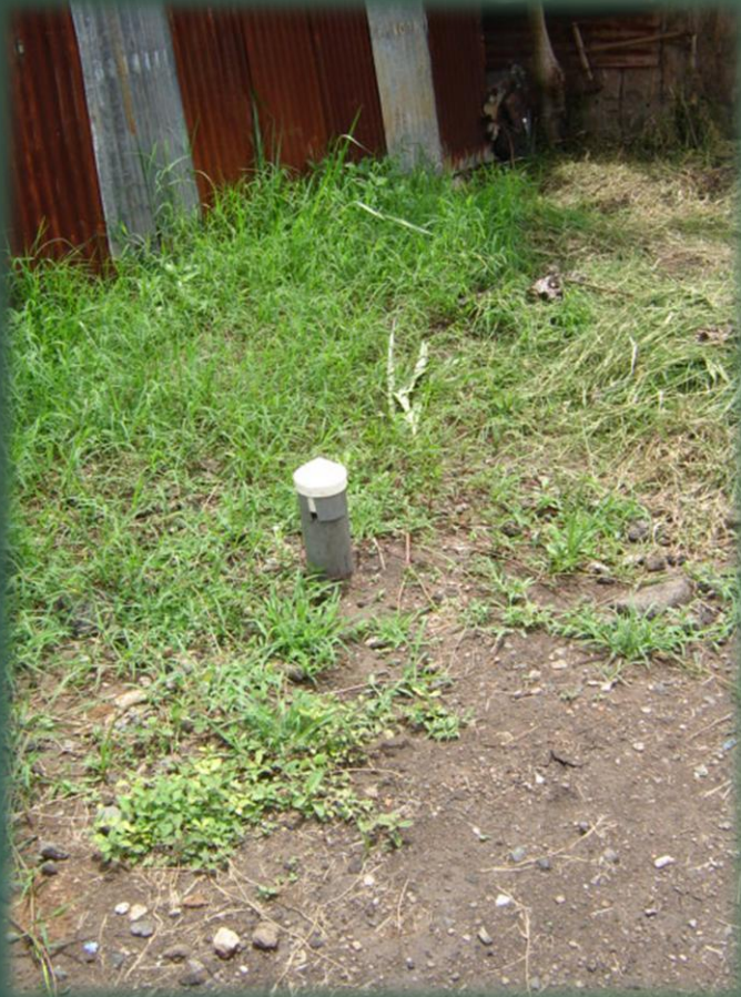
Tanque séptico, 29,5% con problemas constructivos.
